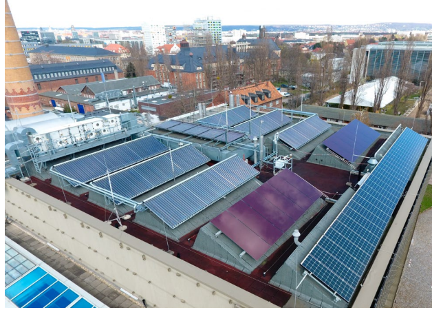
Solarthermische Kollektoren auf dem ZET (Quelle: Ralf Willenberg)
