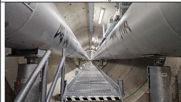
Innenansichten des Dükers mit den Fernwärmeleitungen
