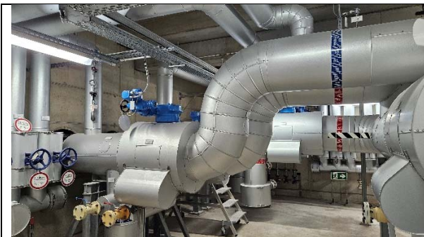
Verteilerstation der Fernwärmeleitungen
