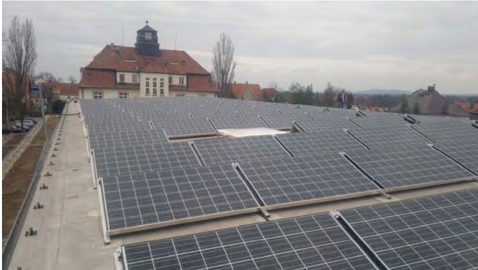
Detailansicht solarelektrische Anlage von Süden
