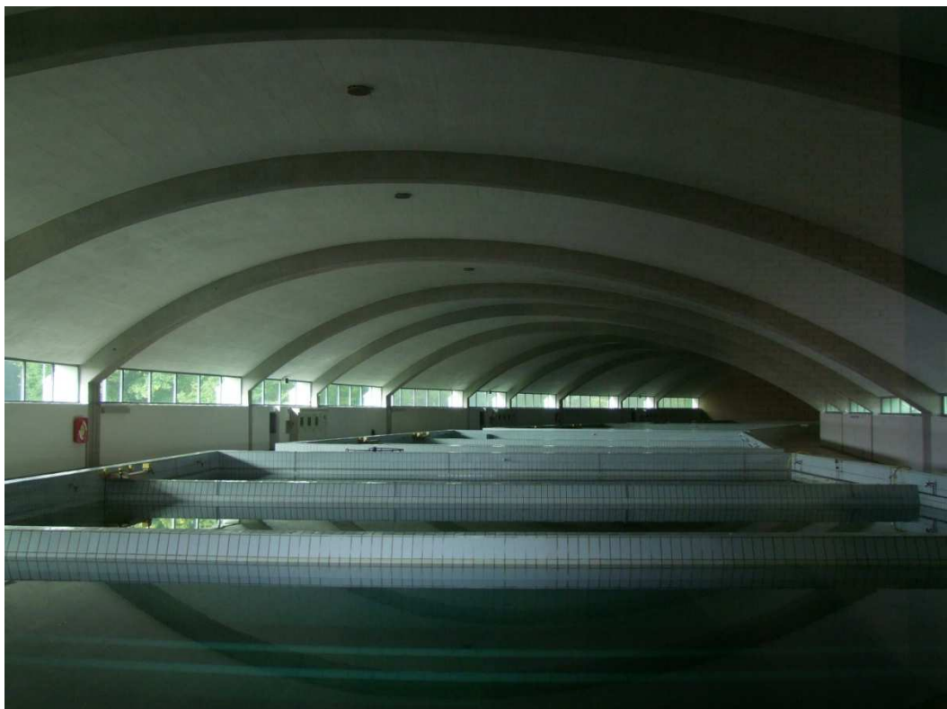
Abb. 6: Wasserwerk Sipplingen - Filterhalle
